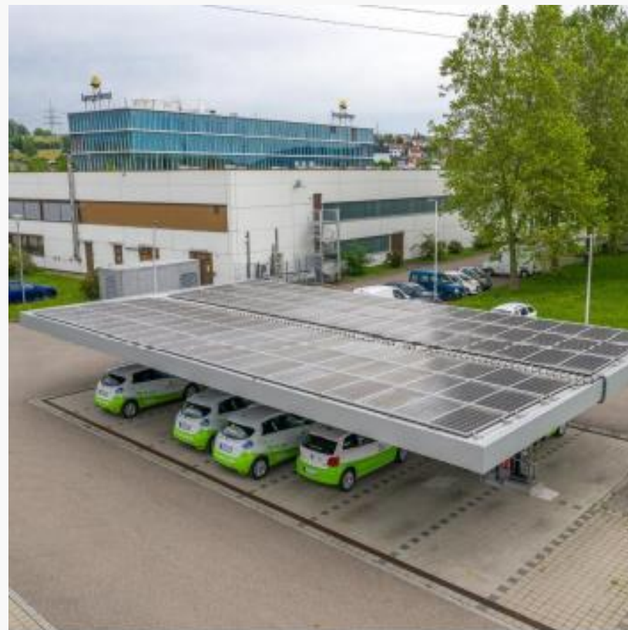
Solar-Carport mit Ladeinfrastruktur in Rheinfelden der Fa. Energiedienst AG
