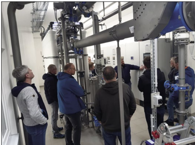
Die Ultrafiltrationsanlage – ein wesentlicher Teil der Wasserversorgung.
