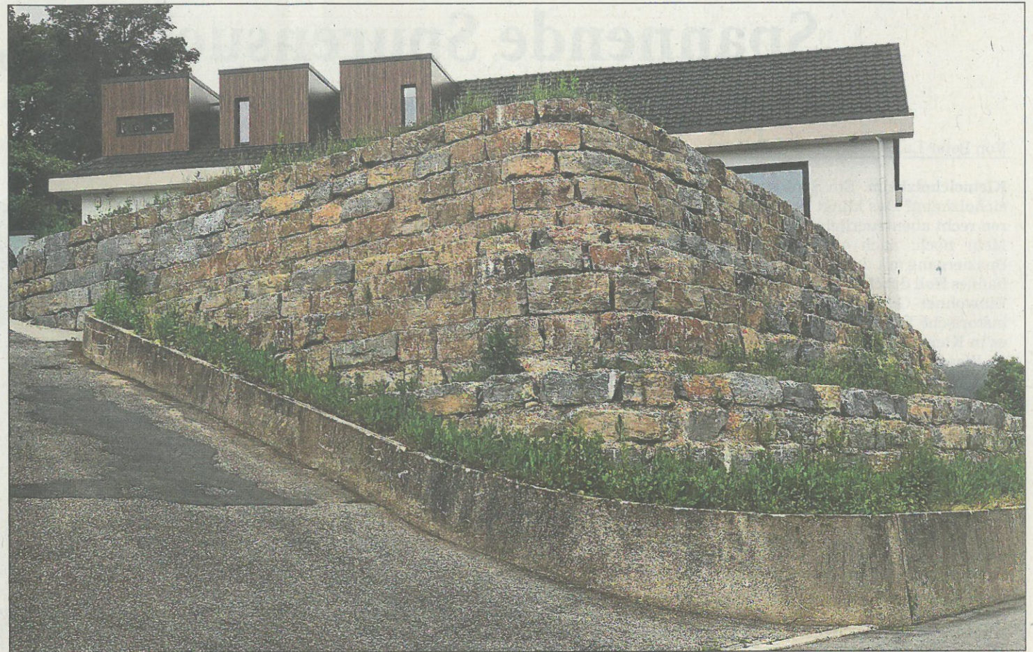
Diese Natursteinmauer in Neckarburken wurde ohne entsprechende Genehmigung gebaut. Es gibt eine Abrissverfügung, der Bauherr hat aber Einspruch eingelegt. Eine Entscheidung gibt es noch nicht. Nun stellte der Bauherr eine Bauvoranfrage und will einen Teil der Mauer zurückbauen. Der Gemeinderat Elztal lehnte diese Bauvoranfrage in der Sitzung am Montag aber ab. Foto: Stephanie Kern
